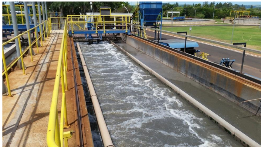
Figura 1: Reator aerado do tipo carrocel da ETE Caiçara
